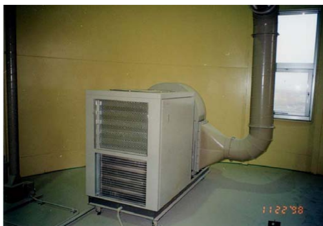
写真2 サイロ内空間自動換気装置
