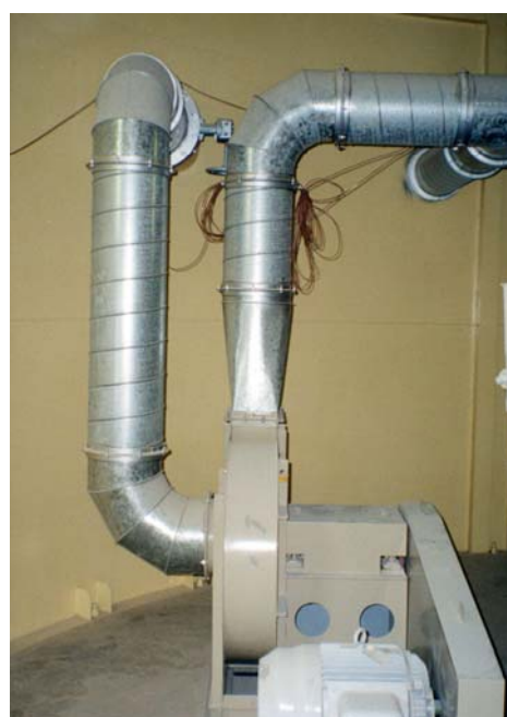
写真3 サイロ通風装置
